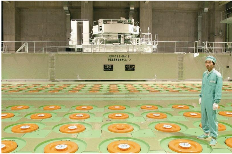
高レベル放射性廃棄物貯蔵管理センター 青森県六ヶ所村、日本原燃(株)
