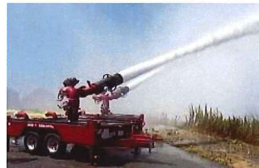
【屋外放水設備】
